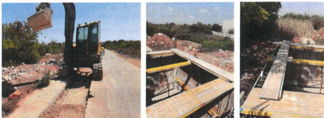
Figura: Obra de Ligação da rede de saneamento do Monte de São Miguel”
