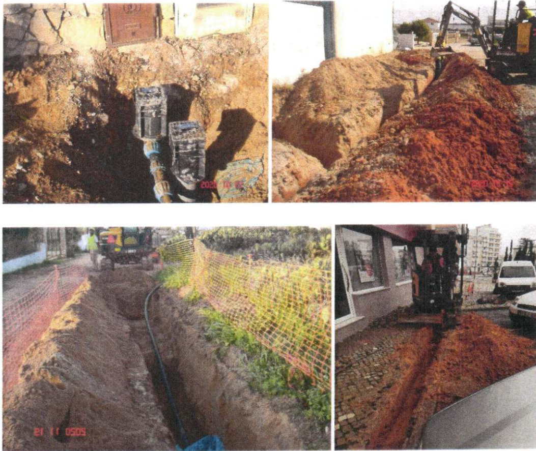
Figura: Obras de reabilitação da rede de abastecimento de água – Desativação da conduta da Fuseta
