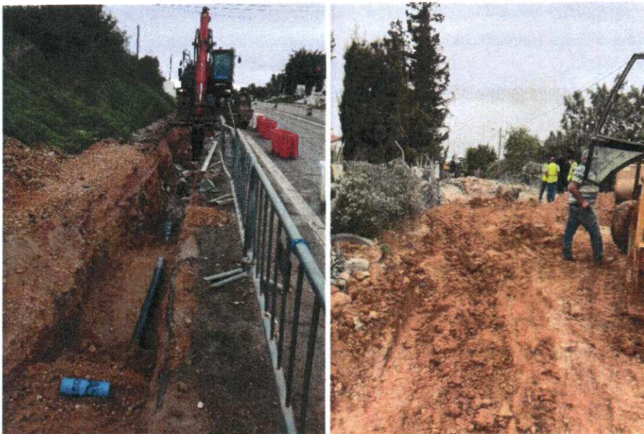
Figura: Trabalhos de reabilitação das redes de abastecimento de água na zona de Bias
