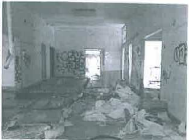
Foto 04 – Vista Interior a partir de um dos vãos exteriores abertos, onde é possível verificar a existência de detritos
