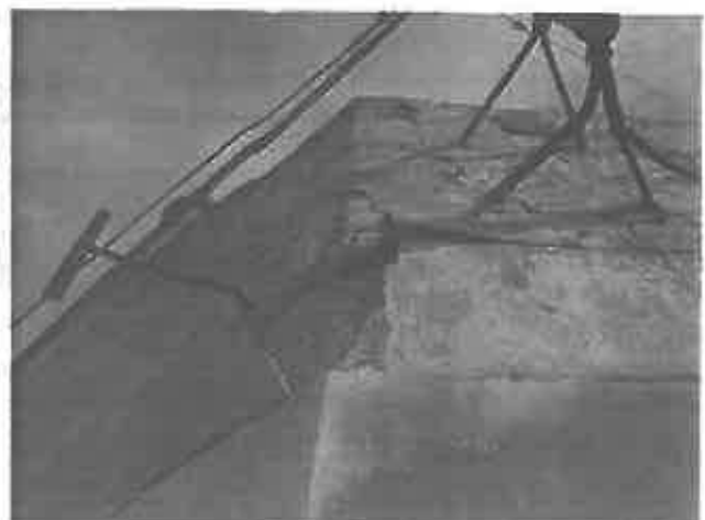
Foto 06 - Desprendimento de reboco nas paredes exteriores
