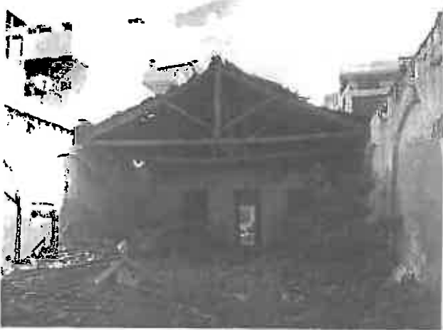
Foto 09 – Cobertura parcialmente abatida. Cobertura em risco de colapso. Acumulação de detritos no interior. Proliferação de vegetação.
