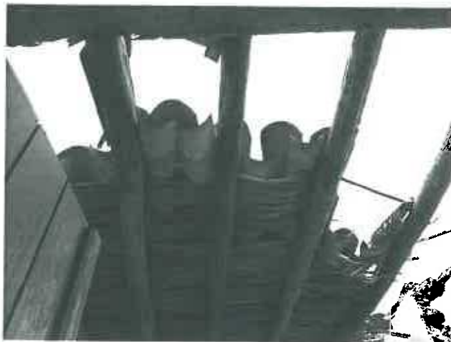
(Cobertura em ruína)
