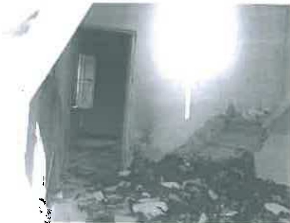
Foto 05 – Vista interior a partir de um dos vãos exteriores abertos, onde é possível verificar a existência de detritos queimados e escadas vandalizadas
