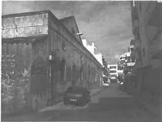
Foto 01 - Rebocos degradados no alçado tardoz
