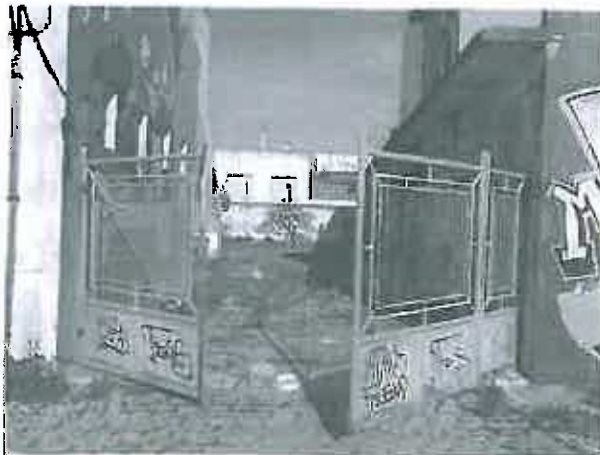
Foto 03 – Portão de acesso ao logradouro, destrancado - rua José do Santos Rufino .
