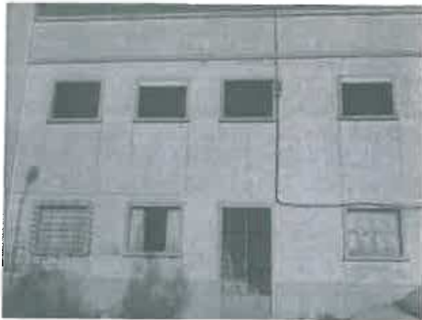
Foto 01 – Alçado sul pela rua José do Santos Rufino. Vãos partidos ou inexistentes
