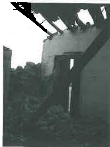
(Estrutura da cobertura em ruína)
