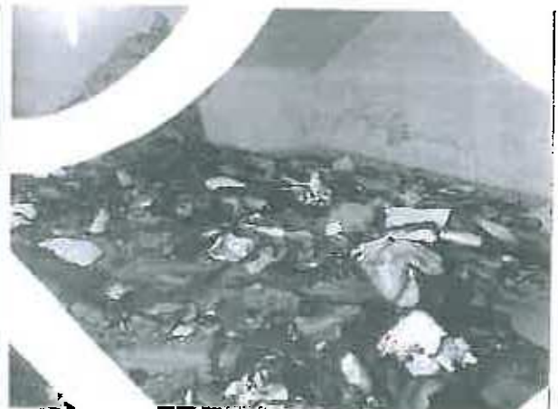
Foto 06 – Vista Interior a partir de um dos vãos exteriores abertos, onde é possível verificar a existência de papéis queimados.
