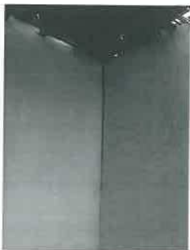
(Fendilhação na ligação entre a parede exterior do alçado nascente e uma parede interior perpendicular àquela)
