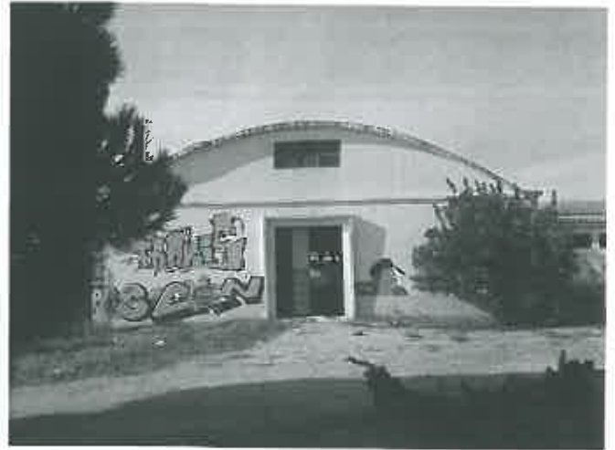
Foto 02 – Alçado nascente. Vão aberto e acessível a partir do logradouro. É possível verificar a existência de uma parede interior parcialmente demolida e a existência de detritos.
