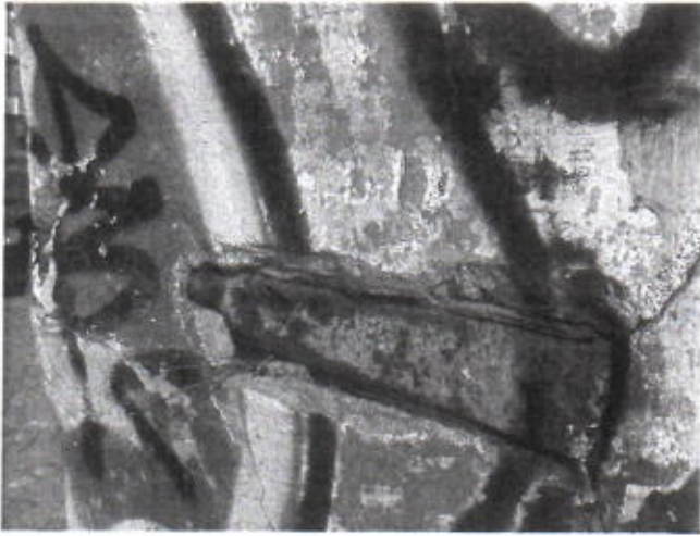
Foto 07 – Desprendimento de reboco nas paredes exteriores
