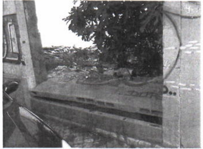
Foto 04 - Vão aberto no alçado principal
