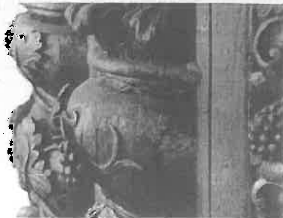
Img. 18 e 19 – Exemplos do estado de conservação da folha metálica.
