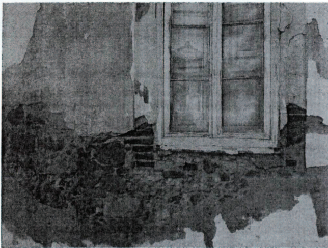
Foto 05 – Destacamento de reboco e pintura
