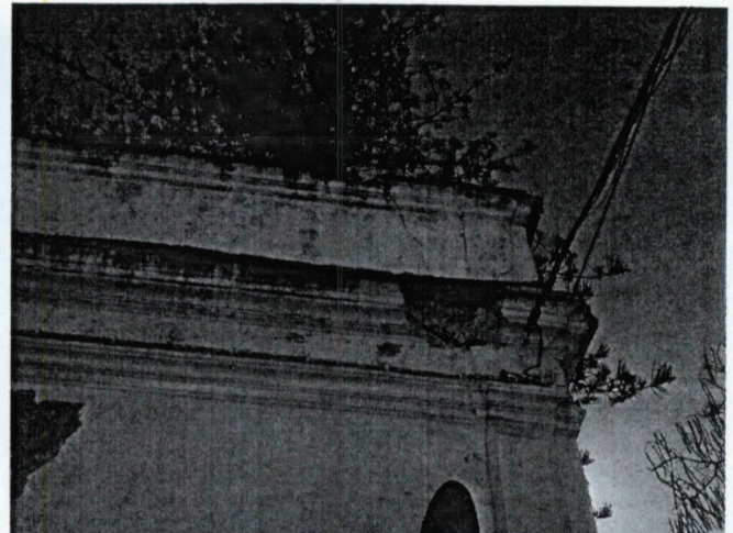
Foto 04 – Fissuração em platibandas
